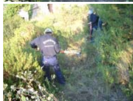
Seqüència de marcatge i desbroçat de línia de defensa utilitzant el Mcleod.
